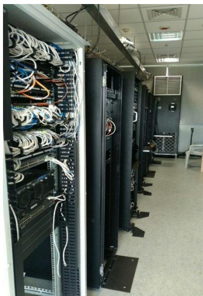
Εικόνα 2: Εξυπηρετητές στο Server Room 002
