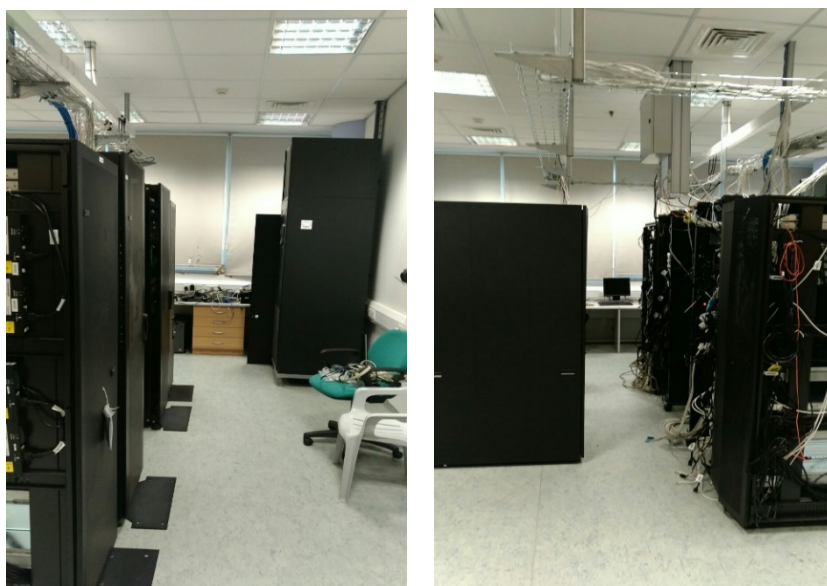
Εικόνα 4: Εξυπηρετητές στο Server Room 004
