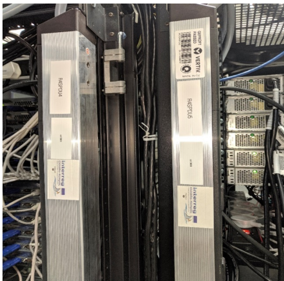
Εικόνα 4: Έξυπνα τροφοδοτικά στο δωμάτιο SR004.
