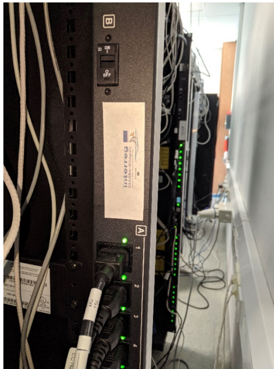
Εικόνα 3: Έξυπνα τροφοδοτικά στο δωμάτιο SR002.
