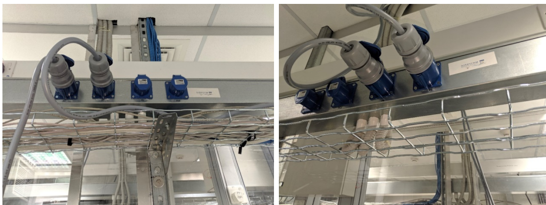
Εικόνα 7: Χρήση της αναβαθμισμένης ηλεκτρολογικής εγκατάστασης.
