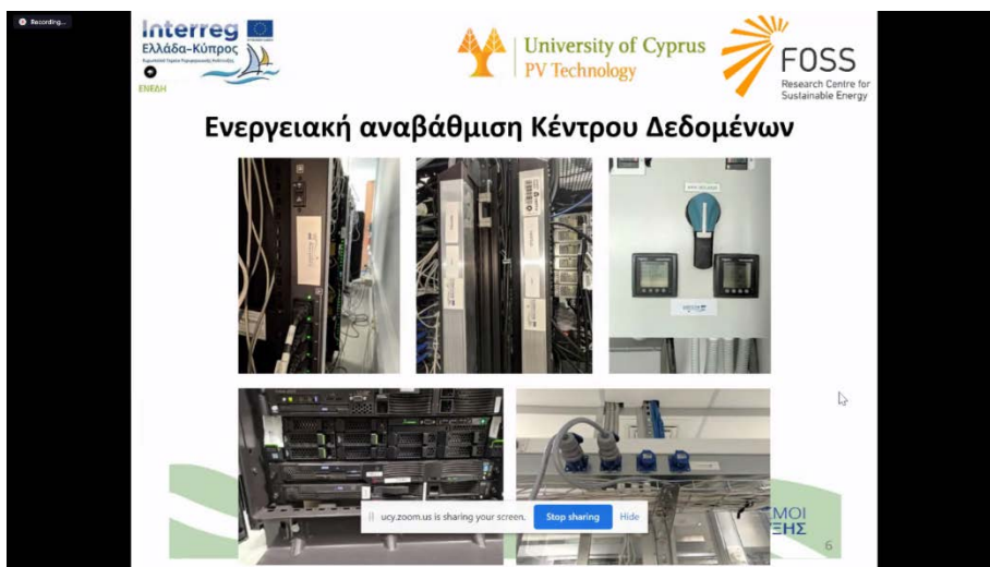
Εικόνα 2: Κέντρο Δεδομένων (servers room)
